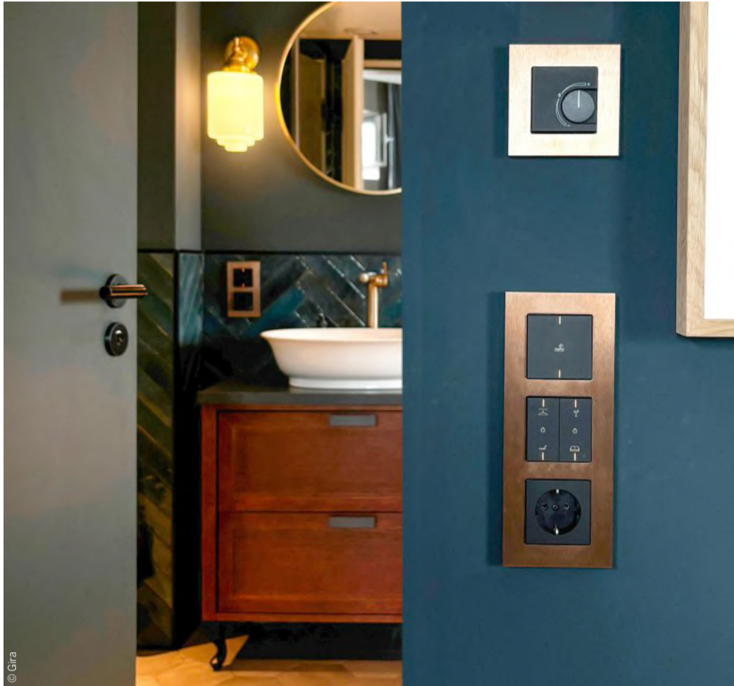
Touchpoint: Schaltzentrale in der Villa Viva Hamburg.
